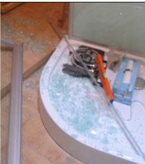
Rampzalig.....de glazen deuren van de douchecabine vielen uit onze handen tijdens het
